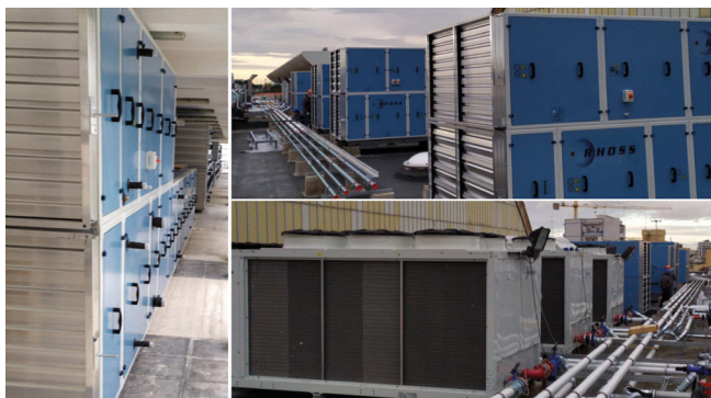
Unità Rhoss installate a servizio di strutture ospedaliere
