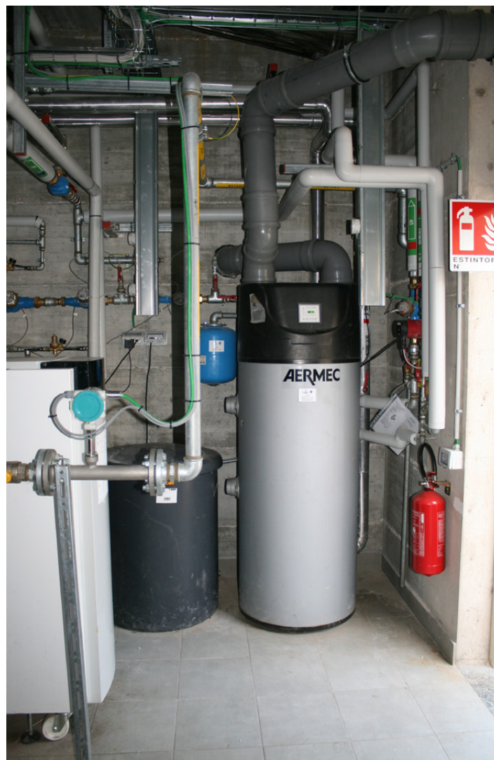
La produzione dell'ACS è affidata a un bollitore che riceve calore integrativo dai generatori termici principali e di backup
