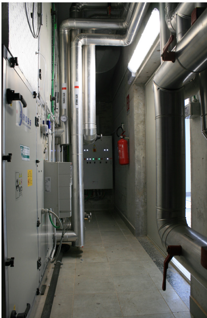
Al piano superiore della torre tecnologica, l'unica UTA fornisce il ricambio igienico dell'aria all'intero edificio con soluzioni mirate alla qualità dell'aria indoor
