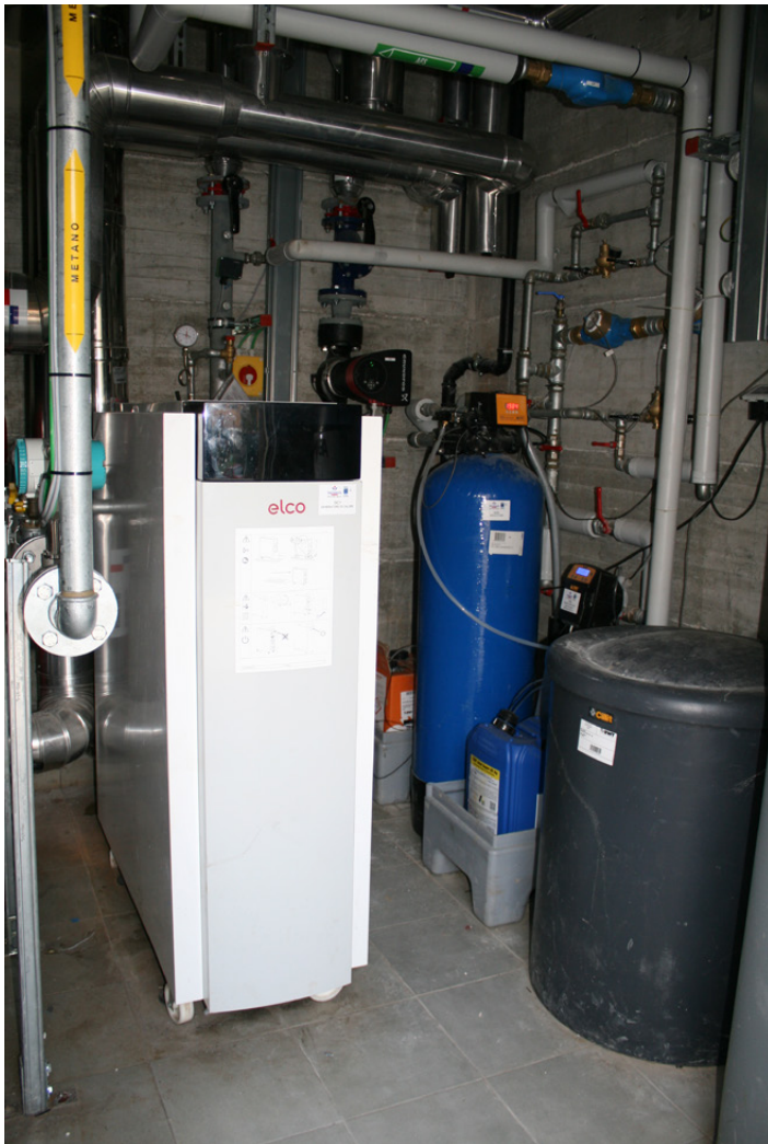
La caldaia a metano svolge funzione di backup completo rispetto alle pompe di calore e, quando necessario, contribuisce al contenimento dei consumi per riscaldamento e ACS
