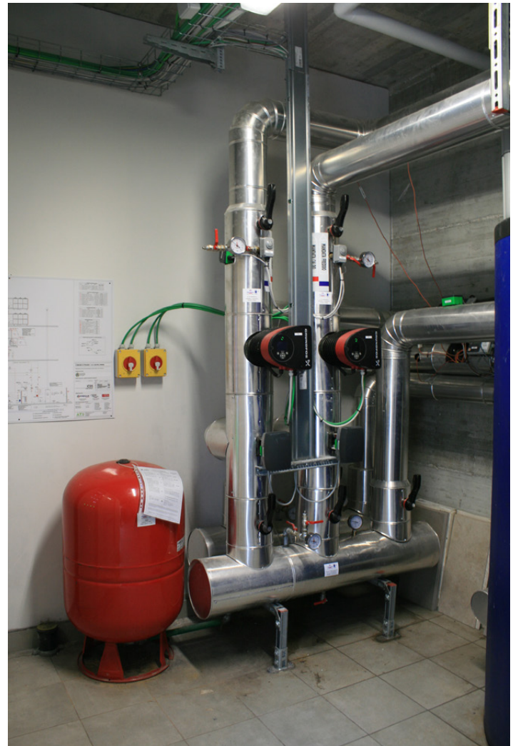
Semplice ed efficiente, l'impianto di climatizzazione prevede solo terminali radianti a pavimento in tutti i locali della scuola, con eventuale integrazione termica ad aria primaria
