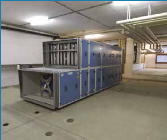
Anwendung im Dienstleistungssektor, Installation im Innenbereich. SCHWEIZ
