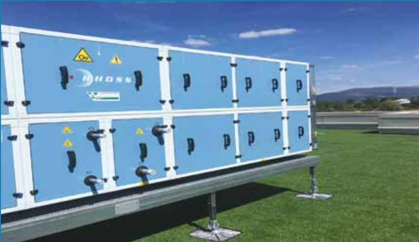
Application tertiaire, installation d'extérieur. ITALIE
